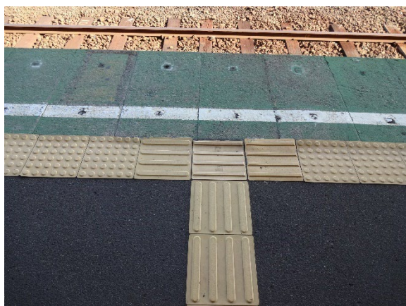
写真 15. 点字ブロックの基本的な設置規則の誤り（JR 根室駅）
