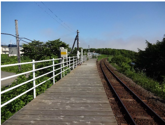
写真 16. ホーム端に警告ブロックが設置されていない（JR 東根室駅）
